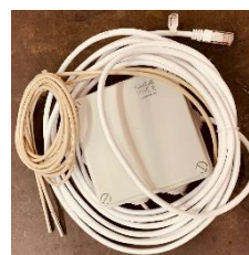
1599 Fördelningslåda till acktankstyrning Cc05 (PX22)
